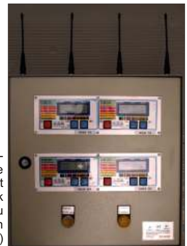
4 Bandrollen- auswertegeräte komplett mit Schaltschrank (damit können bis zu 16 Bandanlagen überwacht werden)
